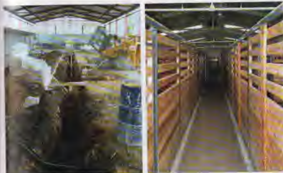
Přechod přestavby pavilonu pro východoafrické kopytníky. Reconstruction of East-African hoofed mammals' house.
